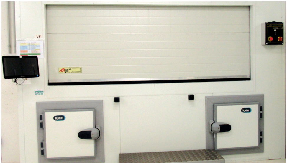
Imagen 2.8. Cámara frigorífica para rotativo vertical.
